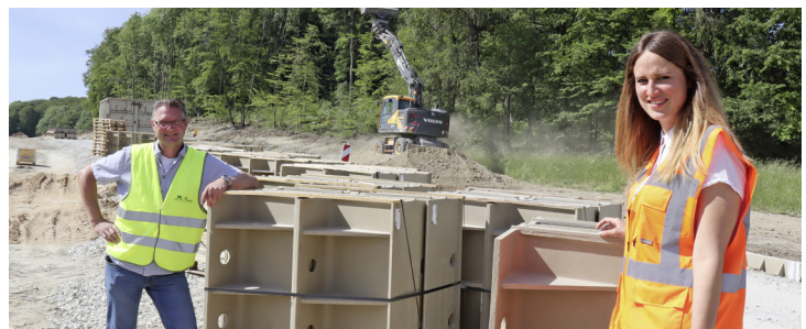
Bauleiter Timo Kohl vom Kreis Gütersloh und Julia Schweinsberg von der Firma Dallmann auf der Baustelle an der K29 (Hengeberg) in Halle (Westf.). Foto: Isabelle Gruschke/Kreis Gütersloh
